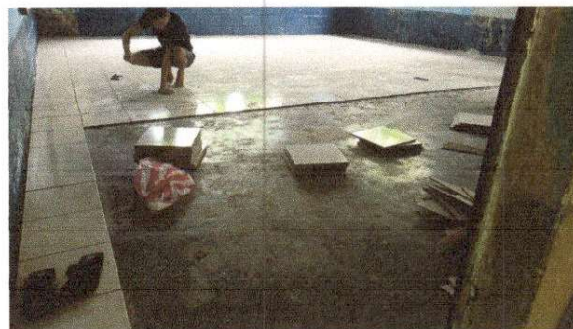
Foto 2: PEGADO DE PISO CERAMICO SOBRE PISO DE CEMENTO
